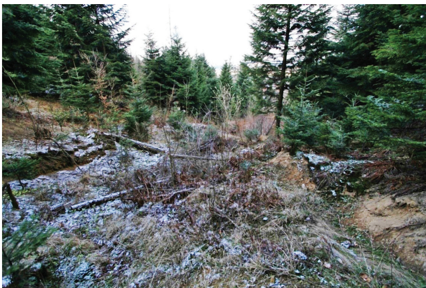
Rys. 1. Fragment powierzchni osuwiska w rejonie skarpy głównej
